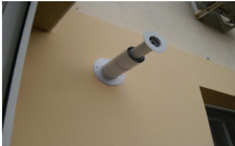
Рис. 3.25 Вихід на вулицю труби з газового котла
